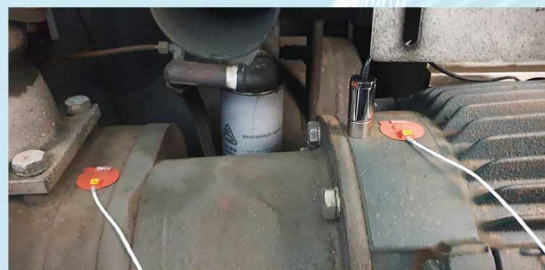
松下電子鼓風機4.0實際架設
