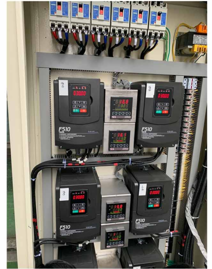
東方科學園區洗滌塔
