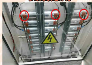
台塑 UPS盤內電容器測溫
