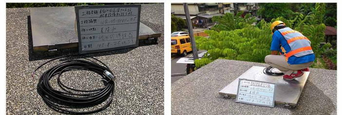
各大自來水廠/加壓站 以上為基隆所御花園加壓站實際架設
